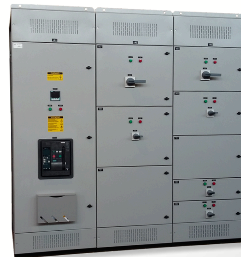
QGBT - QUADRO GERAL DE BAIXA TENSÃO
