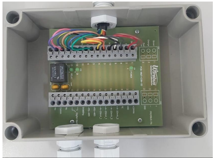
Figura 56 - Caixa de Passagem - Placa Interna
